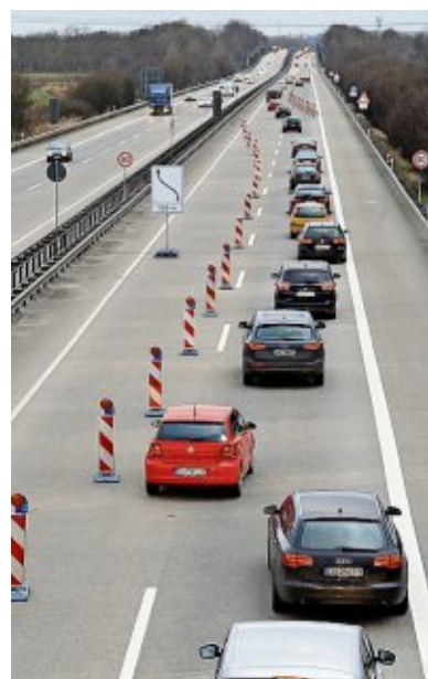
Stau auf der A27: Zwischen Mitte und Überseehäfen wird die „Moorbrücke“ repariert. Fotos Scheschonka
